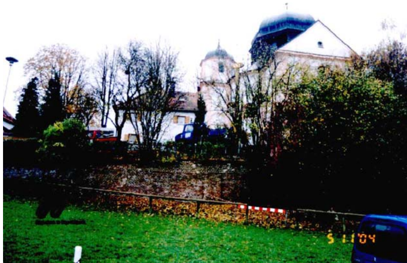
Abb. 2: Verstürzte Stützmauer unterhalb der Wallfahrtskirche Frauenbrünnl.
